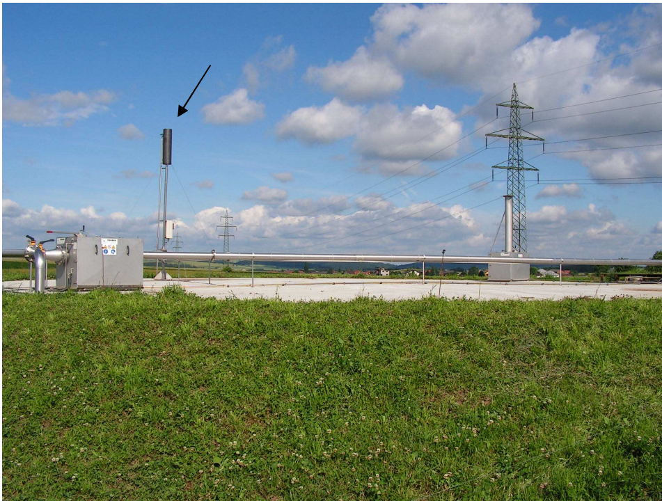
Abbildung 4: Auf Fermenterdecke stehende Gasfackel
