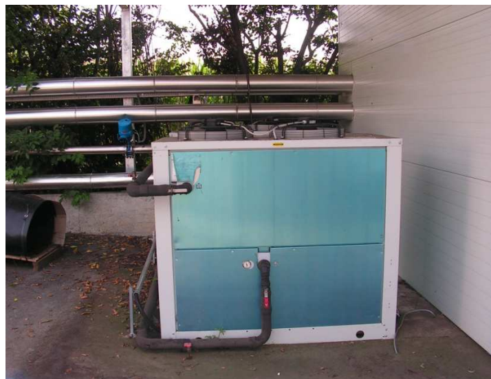
Abbildung 15: Gaskühler der Mikrogasturbine
